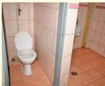
W kabinie nie ma drzwi. Dyrekcja szkoły zapewnia, że wkrótce zostaną zamontowane
