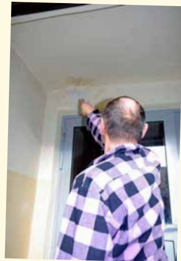
Lokator pokazuje zacieki na suficie
