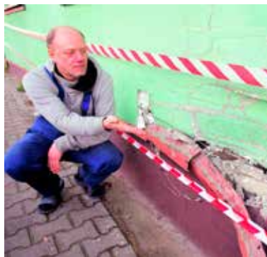
Pan Ireneusz pokazuje zniszczenia elewacji
