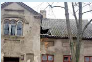
Z dachu lecą na chodnik kawałki azbestowych płyt
