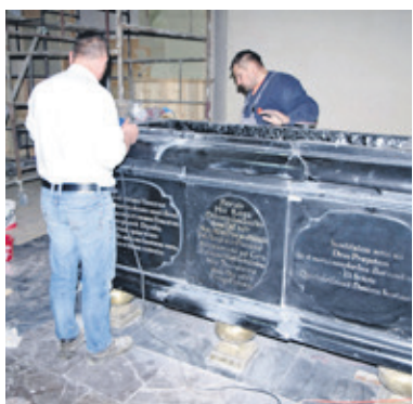
Sarkofag ma liczne pęknięcia
