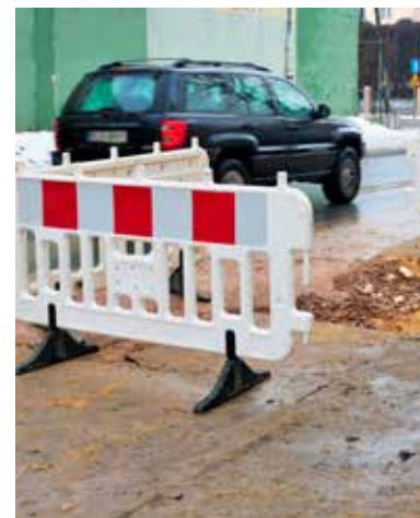
Pękła główna rura zasilająca w ulicy Belwederskiej na wysokości hali sportowej przy SP nr 1
