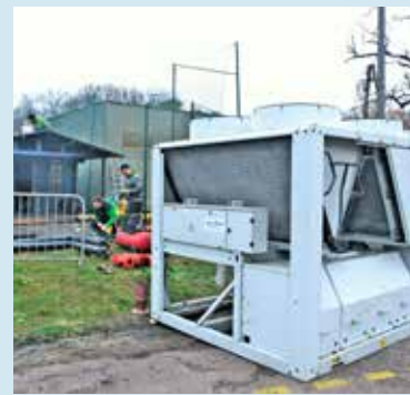
Przy lodowisku znajduje się specjalistyczna aparatura chłodząca taflę a także zaplecze
