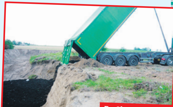
Do Sławęcina zwożone są osady ściekowe
