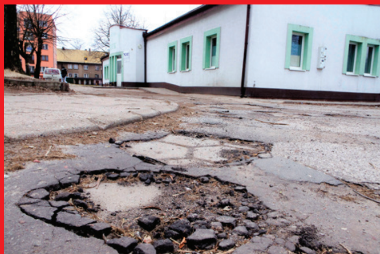
Ogromne dziury przed przychodnią. Na remont nie ma na razie co liczyć...
