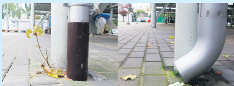
Spusty rynien zostały wpuszczone do kanalizacji tylko od strony pawilonu handlowego. Od strony rzeki rynien, póki co, robotnicy nie ruszali
