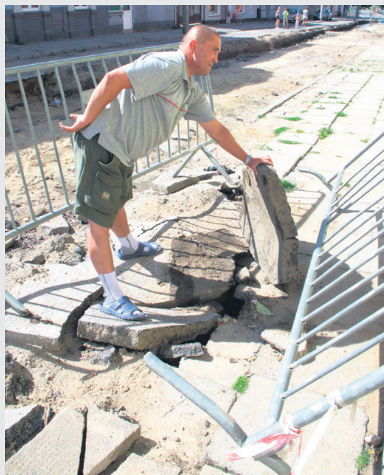
Andrzej Matusiak pokazuje zniszczoną kanalizację sanitarną
