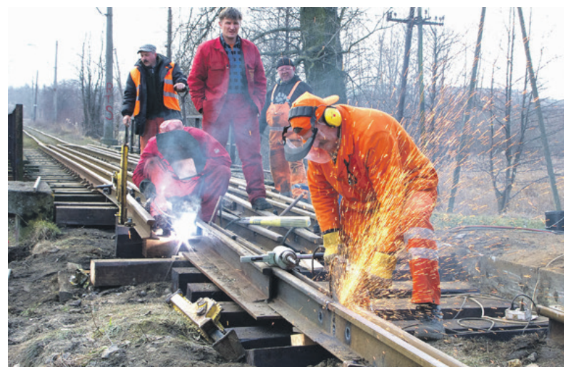
Remont torowiska na mostku był przeprowadzony 2 lata temu. MPK chce ponownie wyremontować ten fragment
