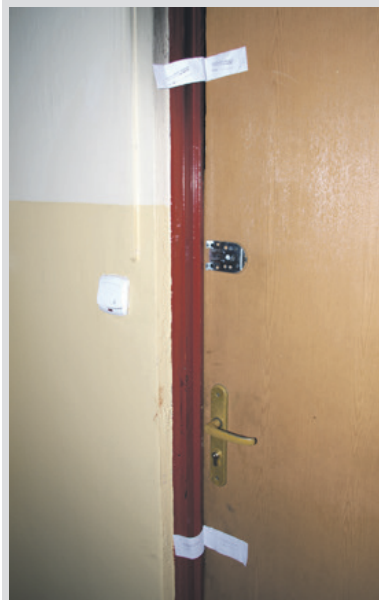
Zaplombowane drzwi do zrujnowanego po wybuchu mieszkania
