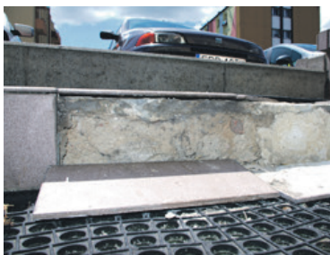
Zdewastowane schody do pomieszczeń piwnicznych
