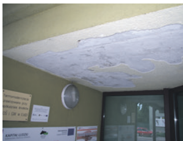
Nad wejściem do urzędu odpadł duży fragment tynku
