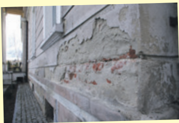
Z elewacji odpada tynk
