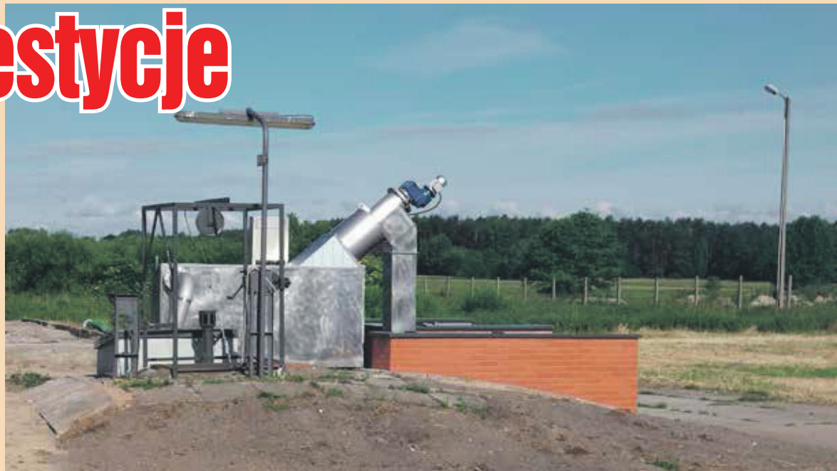
Zmodernizowana oczyszczalnia ścieków, przy ul. Kątnej
