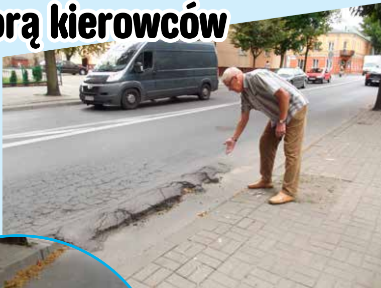
Andrzej Kubiak pokazuje niebezpieczną wyrwę na ul. Belwederskiej
