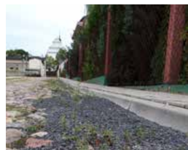
Na poboczu ul. Wodnej leży sfrezowany asfalt
