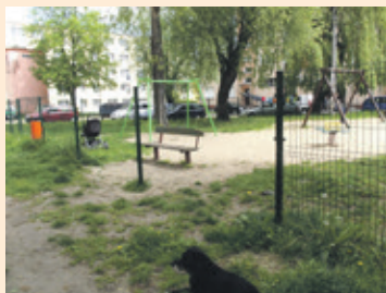
W ogrodzeniu brakuje kilku paneli
