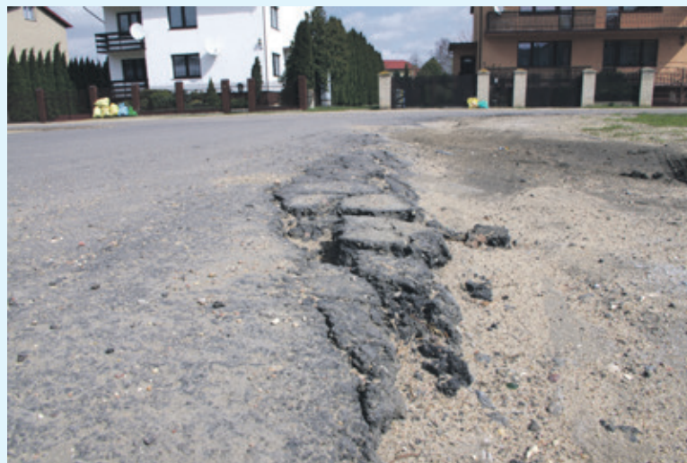
Nawierzchnia jest coraz bardziej zniszczona
