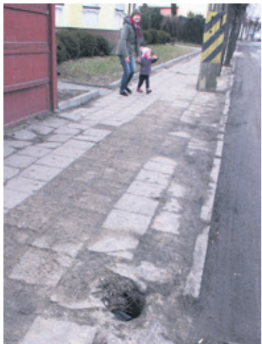
Dziura w pobliżu budynku urzędu miasta, przy ul. Listopadowej
