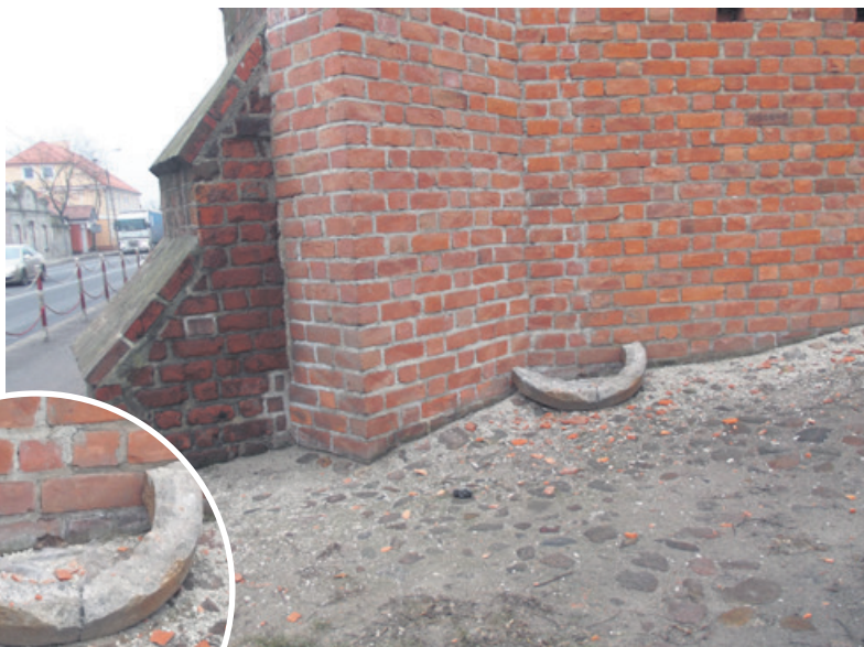
Pod murami widać kawałki pokruszonych cegieł
