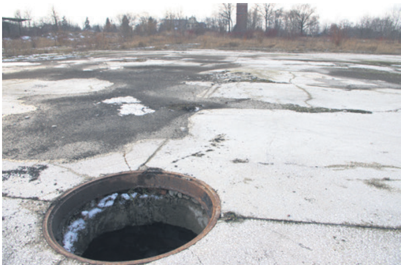
Na placu jest sporo niezabezpieczonych studzienek
