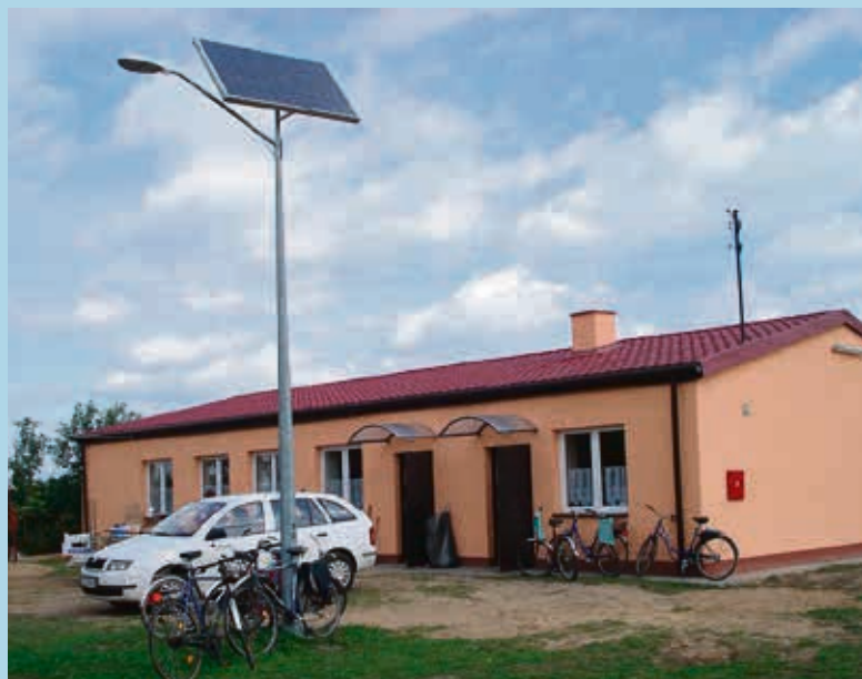
Lampa z ogniwem fotowoltaicznym w Łubnie przy remizie strażackiej
