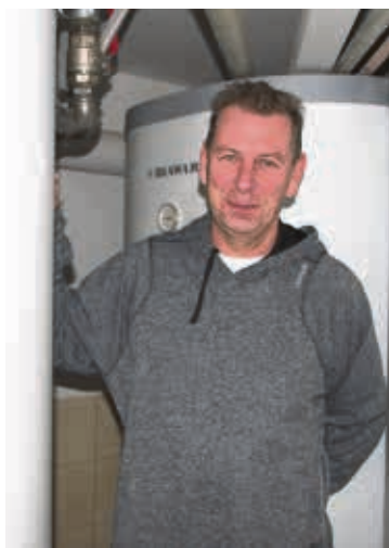
Jacek Potocki w kotłowni. Brakuje jedynie pomp ciepłych
