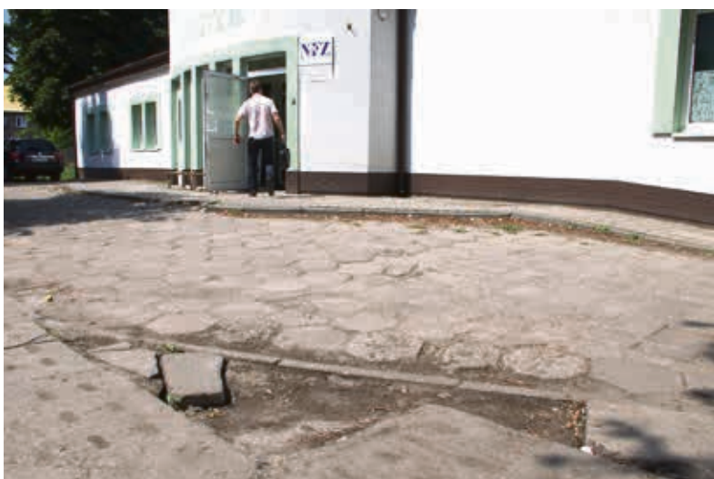
Przed przychodnią zdrowia chodnik jest w złym stanie
