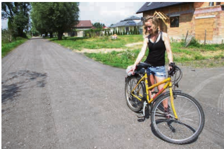
Ul. Kątna wysypana została żużlem. Nawet rowerzyści narzekają na stan drogi
