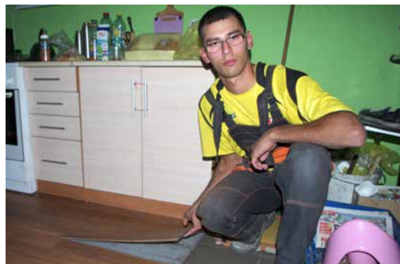
Panele odchodzą już od podłoża. Kiedy podłoga będzie remontowana?
