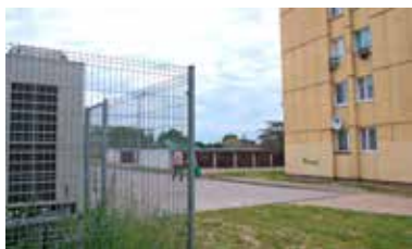
Agregaty pracują w bliskiej odległości od bloku
