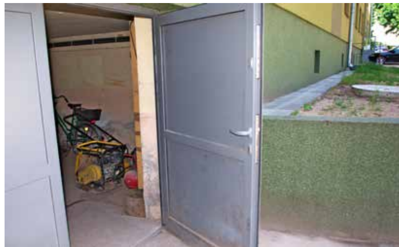
Drzwi do piwnicy urzędu były otwarte na oścież
