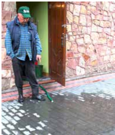
Wodę z piwnicy trzeba było wypompować
