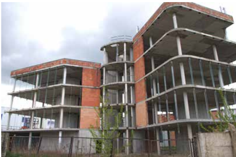
Szkielet niedokończonego budynku administracyjno-hotelowego straszy od lat
