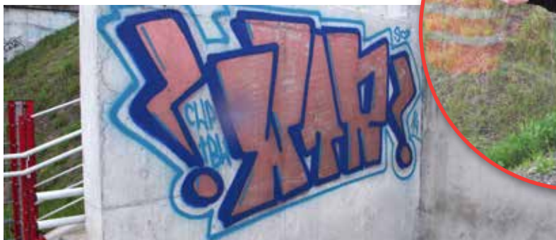
Na nowym przystanku kolejowym jest coraz więcej bohomazów
