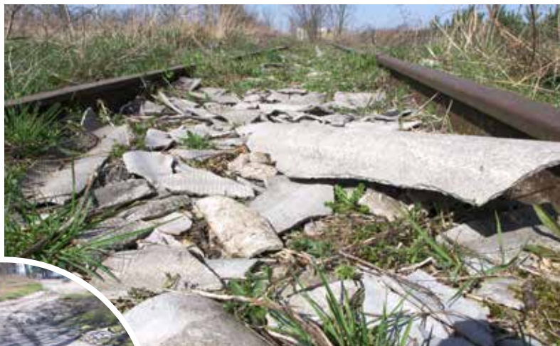
Azbest wylądował na torach i pobliskiej drodze znajdującej się przy nieczynnej rampie kolejowej
