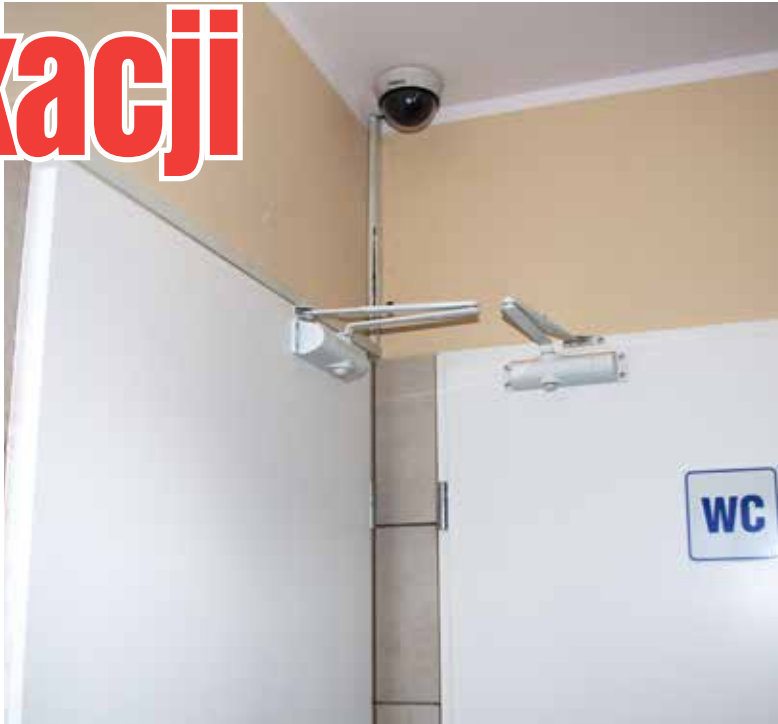
Jedna z kamer została zainstalowana w szalecie publicznym
