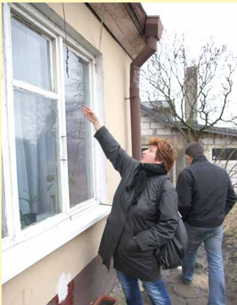
Okna już dawno powinny zostać wymienione na nowe - twierdzą lokatorzy
