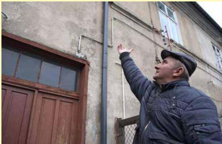
Szara i zniszczona elewacja nie została wyremontowana - mówi Janusz Kindela
