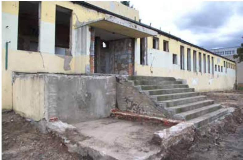
Ruina nie jest ogrodzona
