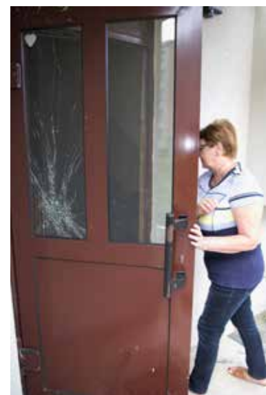
Lokatorzy narzekają na wandalów, którzy niszczą drzwi do klatek schodowych
